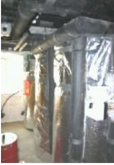
Izolace solárních zásobníků
