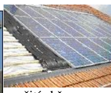
využití ohřevu fotovoltaiky
